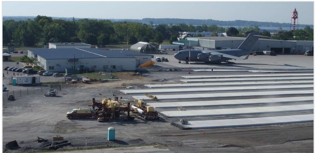
La première phase d'un projet 90 millions $ pour remplacer l'aire de trafic à Trenton a été complétée en novembre dernier.
