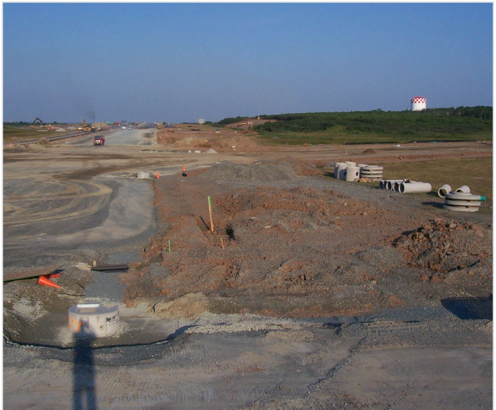
La mise en place de la première couche de béton de l'installation de soutien commun de la 12 e Escadre a eu lieu à la mi-juillet.
