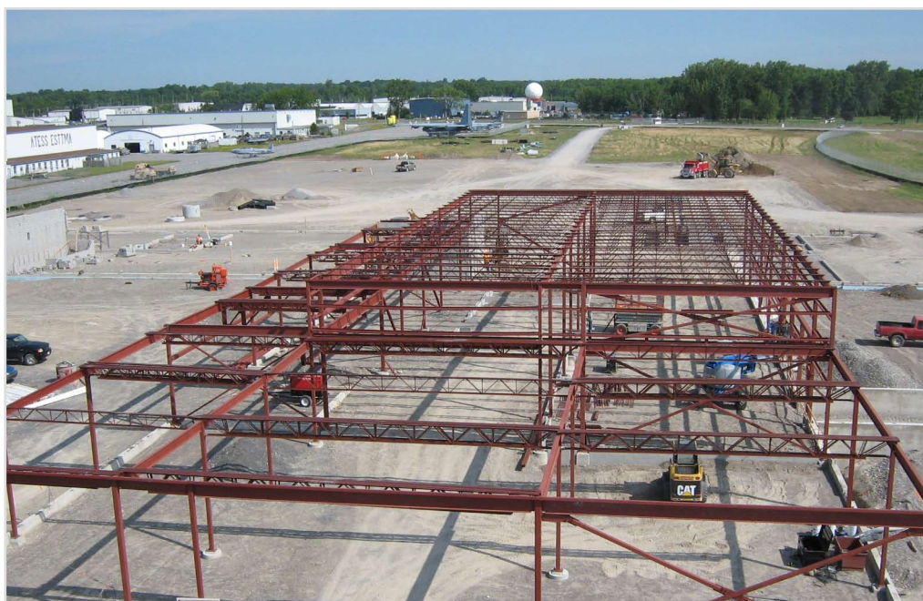
Le chantier de construction de la première installation destinée à la compagnie interarmées de défense nucléaire, biologique et chimique du MDN (CIDNBC) à la 8 e Escadre Trenton centre. Cette photo a été prise le 23 juillet 2007.
